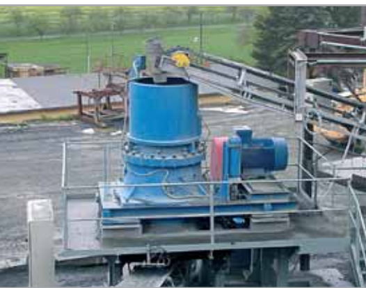
Broyeur à cône KDC 33GP – broyage du silicate
