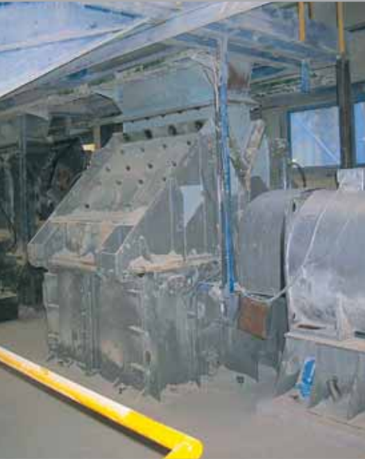
Broyeur à marteaux KMR 2145 – broyage du calcaire pour la désulfuration
