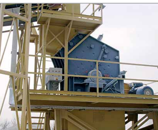
Broyeur à percussion 1500t/h – broyage de la dolomite
