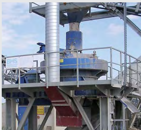
RSMX 1222 avec lit de matériaux pour la production d'agrégats de forme cubique à partir de gravier du Rhin 16-32 mm
